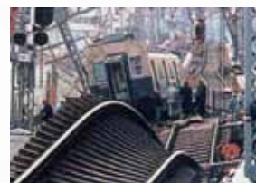
倒壊した高架線路
