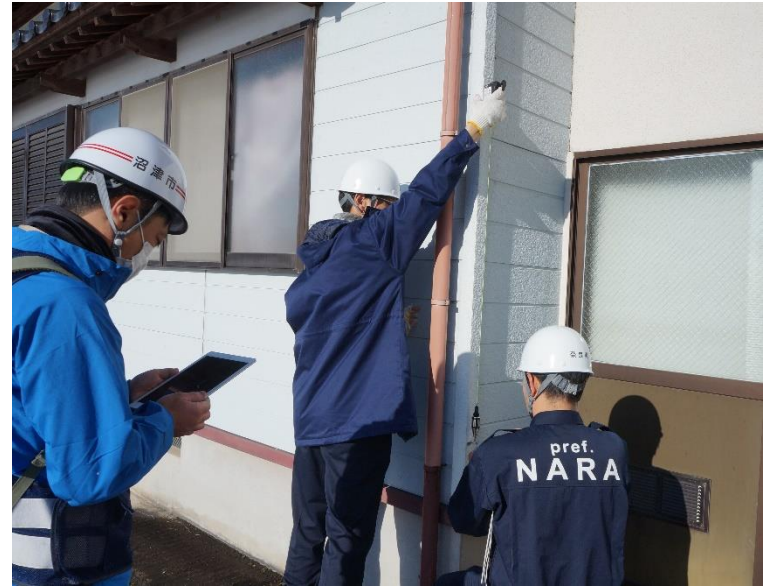
家屋被害認定調査の様子(穴水町内)
