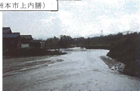
土砂堆積状況(奥畑川:洲本市上内膳)
