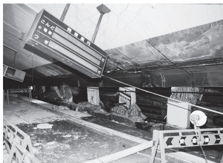
写真 119 神戸高速鉄道大開駅の被災状況 (神戸新聞社提供)
