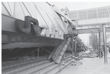
写真 117 JR 六甲道駅の被災状況 (神戸市提供)
