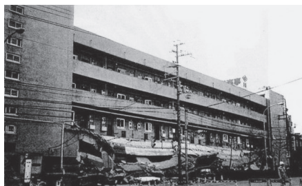
写真 91 被災住宅の部分圧壊の状況
