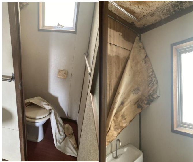
⑧雨漏り(102号室)
