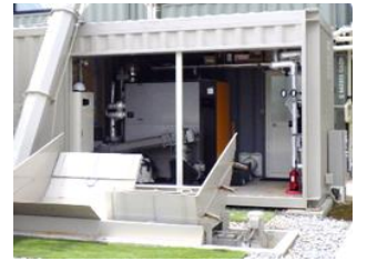
木質バイオマスボイラー(たつの市)
