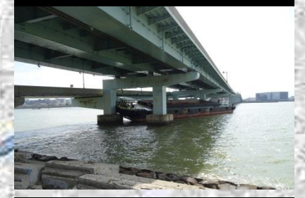
⑫ 防潮堤損壊 L=80m
