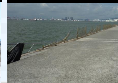
⑥ 防護柵倒壊 L=553m
