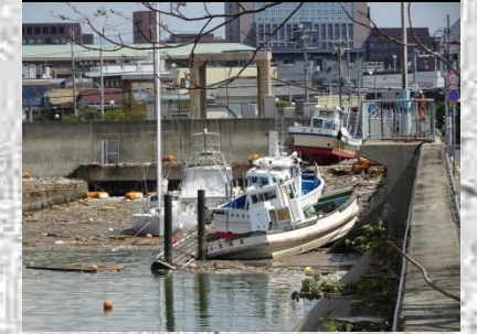
⑬ 船舶の衝突(県道橋)
