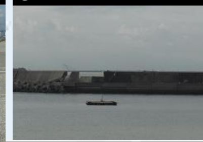
⑦ 防波堤損壊
