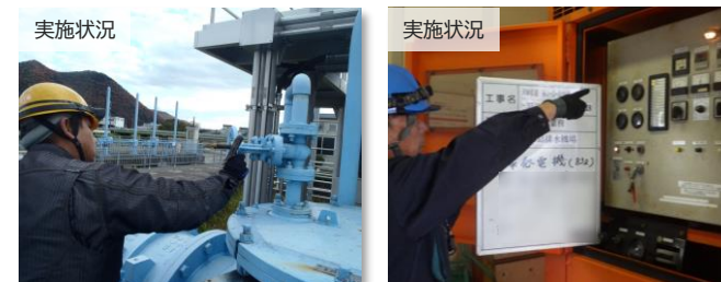
□ 排水機場の定期点検
