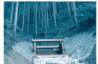
簡易流木止め施設
