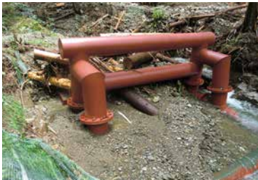
簡易流木止め施設が流木を捕捉
