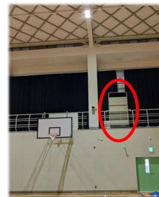
導入した空調設備
