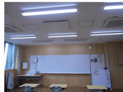
普通教室の空調室内機とLED
