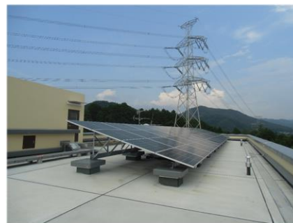
太陽光発電設備
