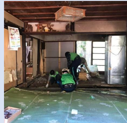
福島沖地震で被害を受けた家屋の片付け
