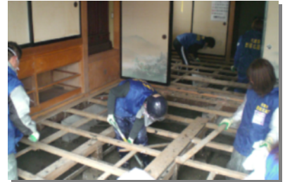
西脇北高校 床下の泥かきボランティア
