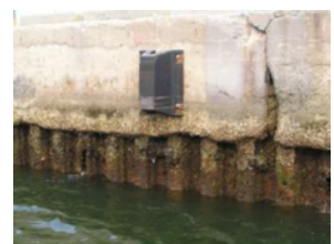
港湾岸壁の腐食
