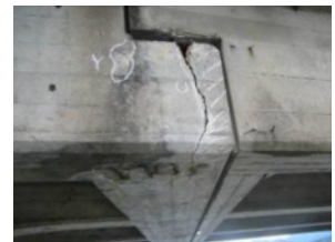
橋梁主桁のひびわれ
