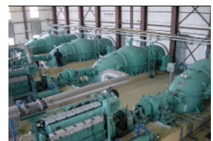
排水機場の老朽化
