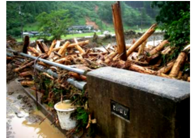
橋の欄干にたまった大量の流木
