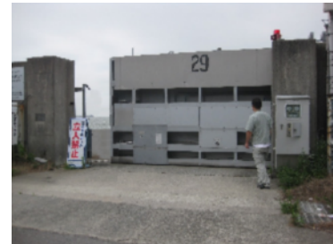
陸閘の閉鎖状況（尼崎西宮芦屋港）
