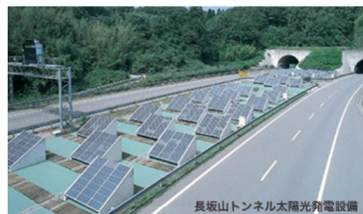
長坂山トンネル太陽光発電設備 高速道路への設置事例
