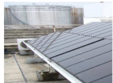
屋上での太陽光発電
