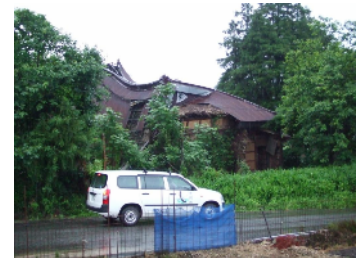
倒壊した空き家(豊岡市)
