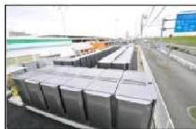
1.2メガワットの燃料電池（SOFC）
