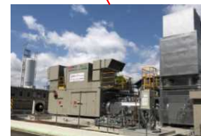
水素発電・熱供給
