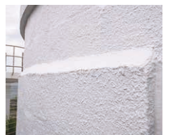
10cmほどずれた外壁に震災の爪痕が残ります。
