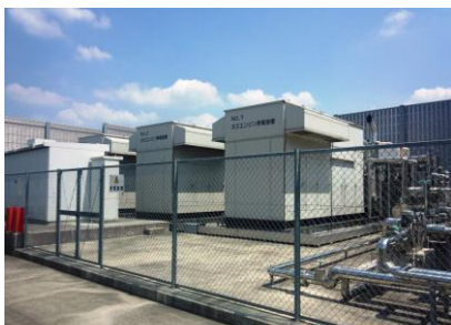
ガス・コージェネ発電設備
