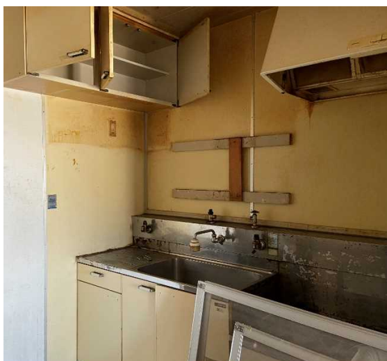
＜老朽化した台所設備＞
