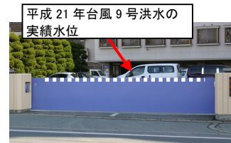
〔佐用中央病院〕浸水防止壁
