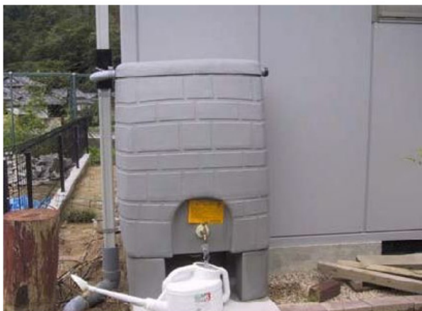
雨水貯留タンク
