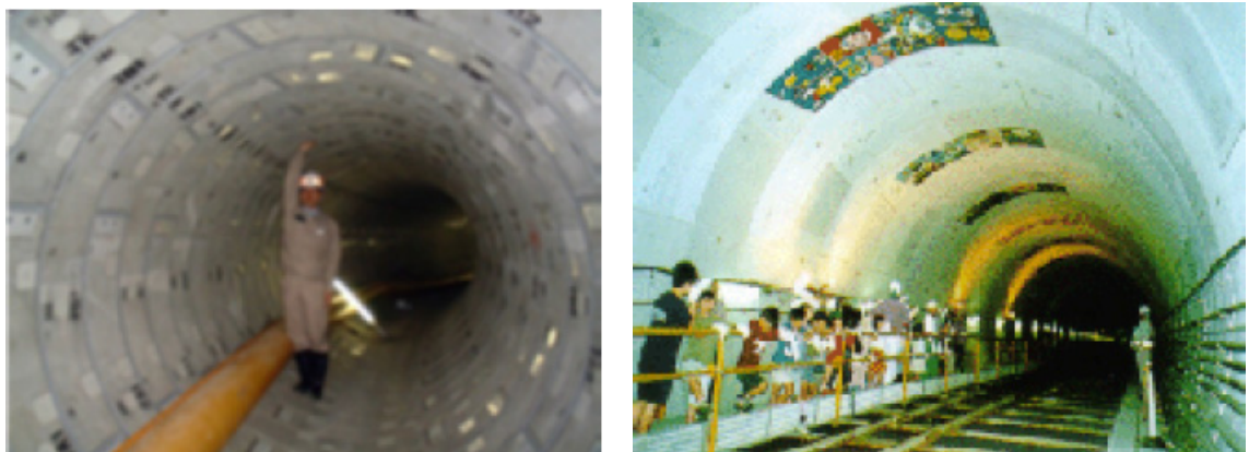
図 5-10 雨水貯留管（左：西宮市、右：伊丹市） （出典：西宮市下水道ビジョン、伊丹市ホームページ）
