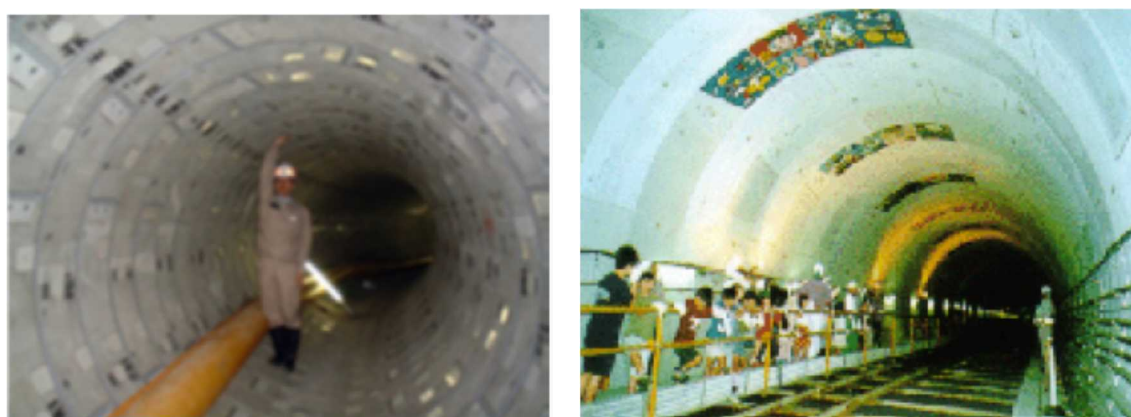
図 5-11 雨水貯留管（左：西宮市、右：伊丹市） （出典：西宮市下水道ビジョン、伊丹市ホームページ）
