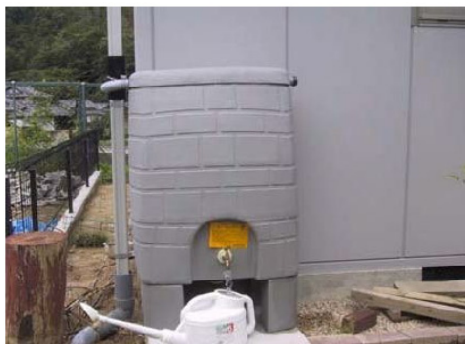
雨水貯留タンク
