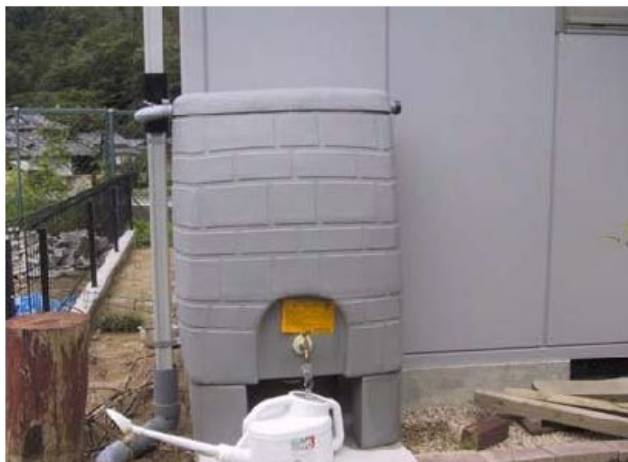
雨水貯留タンク
