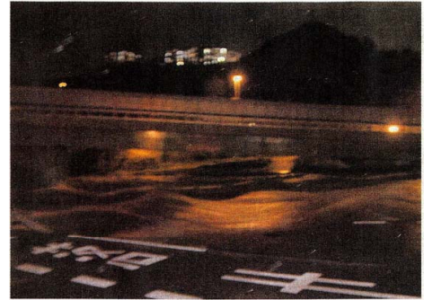
武庫川の増水で陥没した道路（20日午後8時ごろ、西宮市生瀬武庫川側で）
