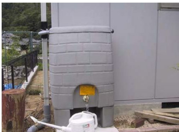
雨水貯留タンク
