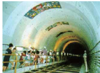
図5-7 雨水貯留管 (伊丹市) (出典: 伊丹市ホームページ)
