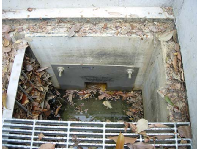
雨水貯留施設 (放流施設)
