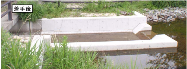
ため池貯留施設 (余水吐)
