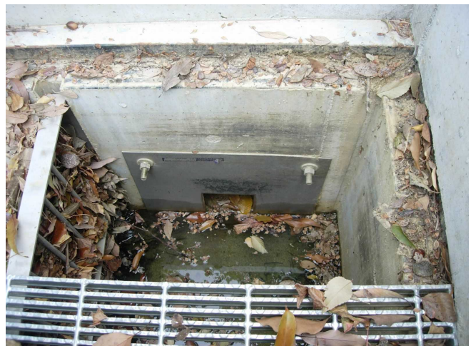
雨水貯留施設（放流施設）
