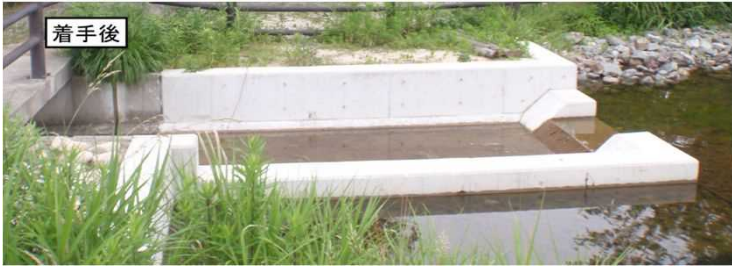
ため池貯留施設 (余水吐)
