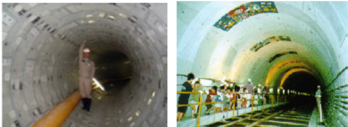
図 5-12 雨水貯留管（左：西宮市、右：伊丹市） （出典：西宮市下水道ビジョン、伊丹市ホームページ）
