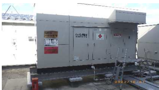
自家発電設備の設置(三田市庁舎)
