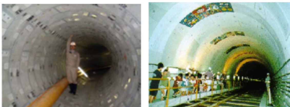
図 5-11 雨水貯留管（左：西宮市、右：伊丹市） （出典：西宮市下水道ビジョン、伊丹市ホームページ）
