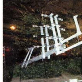
道路陥没で倒れた電柱 (午後8時15分ごろ、西宮市生瀬(武庫川側))
