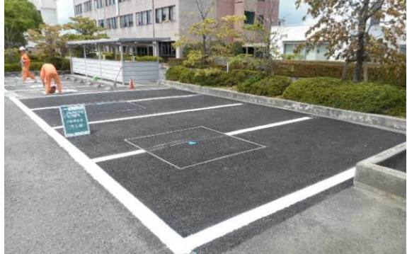
【駐車場】 兵庫県伊丹庁舎
