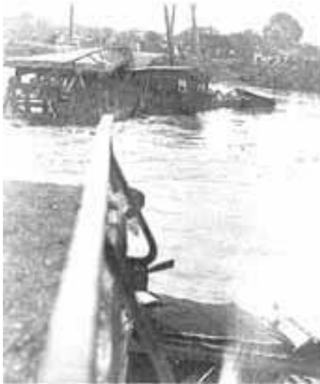
写真) 真っ二つに折れた神崎橋 (昭和13年7月)
