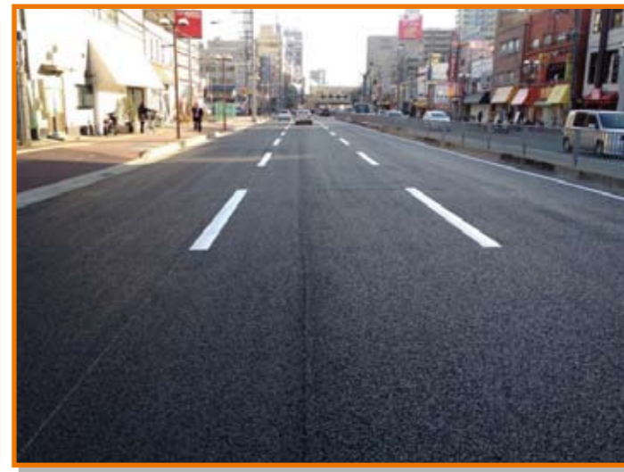
今年1月、川西篠山線 川西市中央町の南行車線において、低騒音舗装工事を行いました
