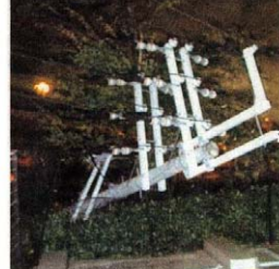
漏電騒音で倒れた電柱（午後8時15分ごろ、西宮市生瀬地区武庫川側で）
