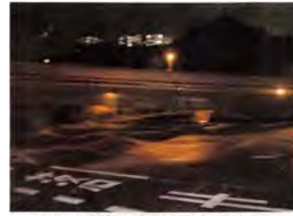
武庫川の増水で陥没した道路（20日午後5時ごろ、神戸市消防局撮影）
