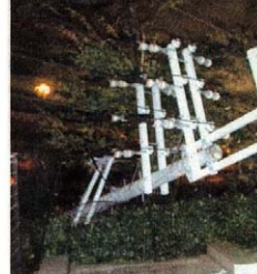
高層ビルで倒れた電柱（午後8時15分ごろ、西宮市生瀬武庫川町で）
