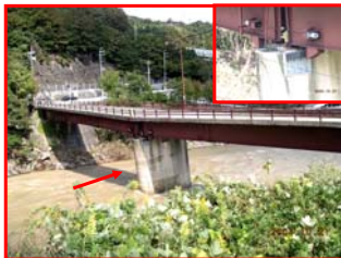
橋脚が傾く森興橋
