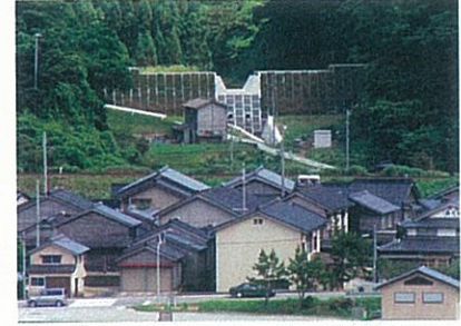
治山ダム、砂防えん堤 大谷川(豊岡市)
