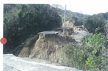
ため池の決壊による道路分断(洲本市上内膳)
