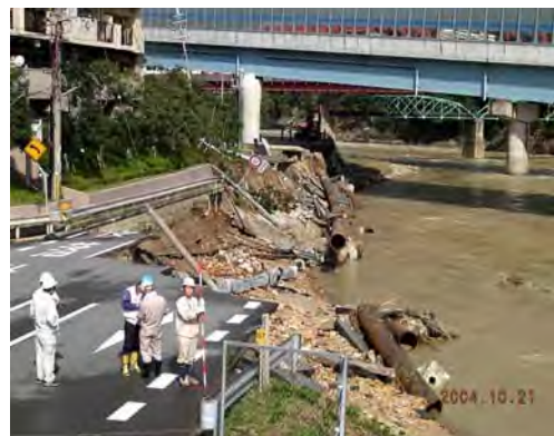
写真 2.2.2 平成 16 年台風 23 号の被災写真 (生瀬大橋上流右岸側)
