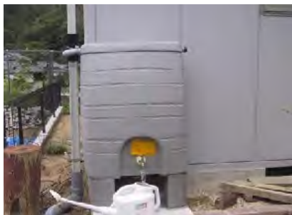
写真 2.2.10 雨水貯留タンク各戸貯留
