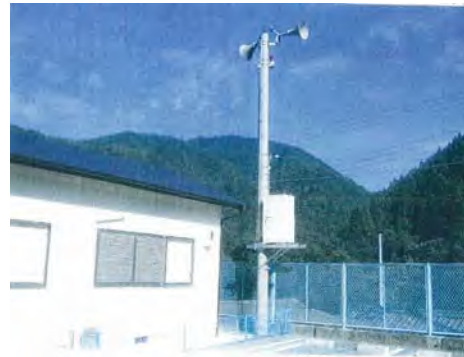
写真 2. 2. 15 洪水危険情報通報システム (サイレン・回転灯の設置)
