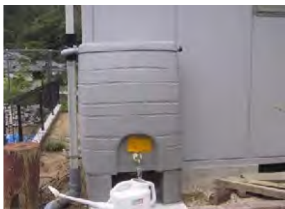
写真 2.2.10 雨水貯留タンク各戸貯留
