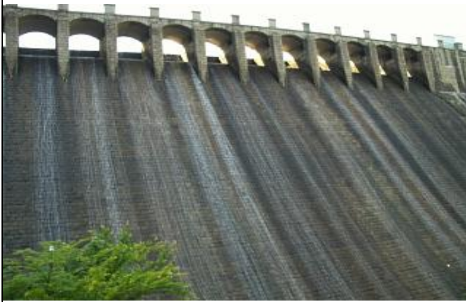
千苺ダムのスライドゲート (17基)
