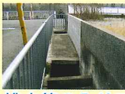
排水管の入り口 用水路は、ここから排水管へ入る。あふれる時はここから逆流する。
