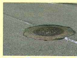
マンホールのふた 数メートル飛び上がることもある。はずれると泥水で見えず歩くのは危険。
